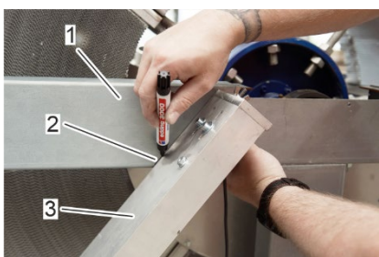
Figura 26: Marcado de la posición sobre el riel de limpieza
